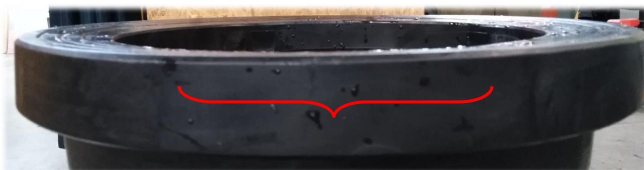
Zdjęcie 8. Tuleja wtryskowa - widok deformacji kołnierza w miejscu wypchnięcia uszczelki
