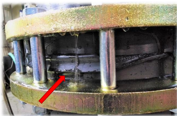
Zdjęcie 4. Widok wypchniętej uszczelki po rozkręceniu połączenia.
